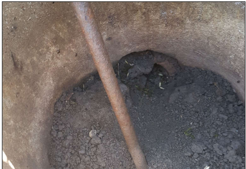
Figur 9: Delvist jordfyldt brønd i afvandingssystem 4.
